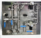
自主气控单元 Air control unit
